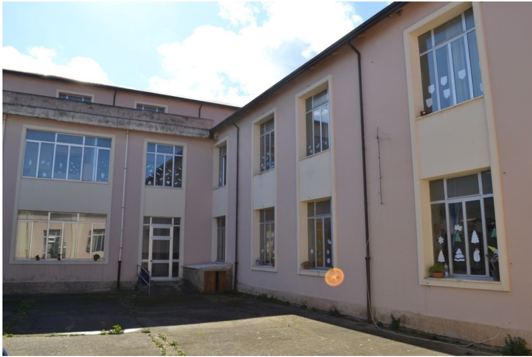
Vista corte interna – Vista aere Scuola dell’Infanzia e Primaria “Piria” via Nuarella
